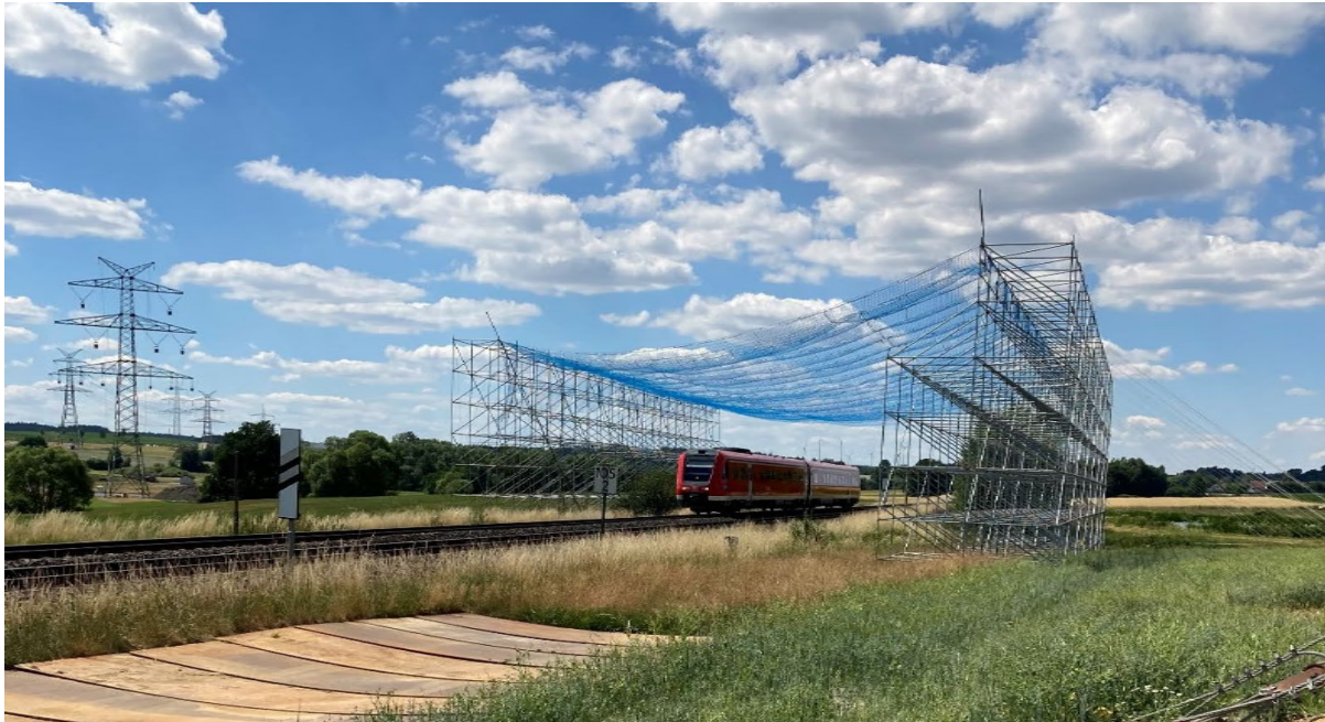
Abbildung 11: Beispiel für ein Schutzgerüst aus Stahl
