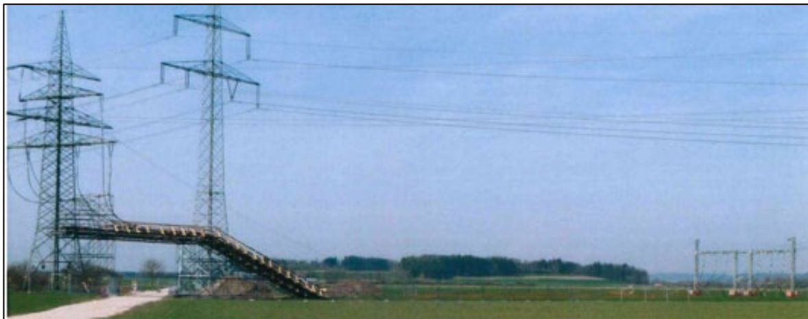
Abbildung 16: Kabelbrücken im Bereich der Provisorien zur Querung von Straßen
