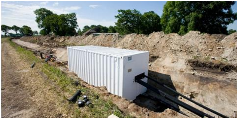
Abbildung 32: Beispiel für Muffengruben und -container
