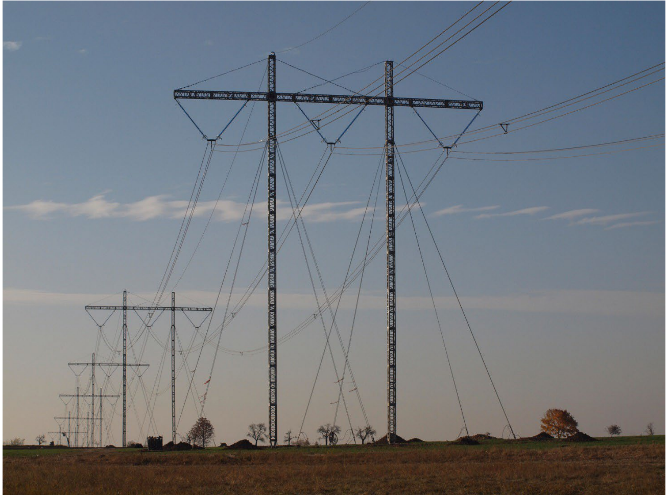
Abbildung 7: Beispiel für ein 380-kV-Freileitungsprovisorium (Quelle: SAG)
