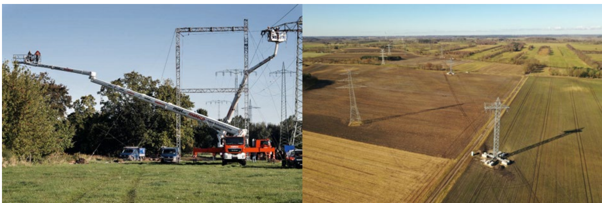
Abbildung 20: Beispiele für 110-kV-Freileitungsprovisorien
