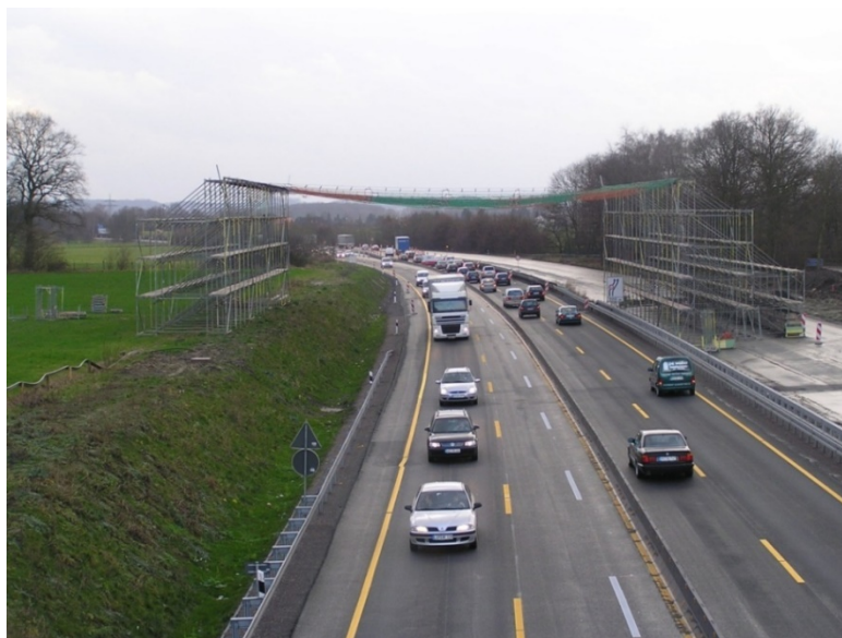
Abbildung 23: Stahlrohrschutzkonstruktion mit Netz über einer Autobahn
