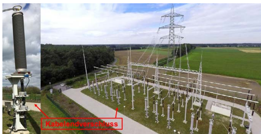
Abbildung 31: 380-kV-Kabelendverschluss (links) und Anordnung der Kabelendverschlüsse in KÜS (rechts)
