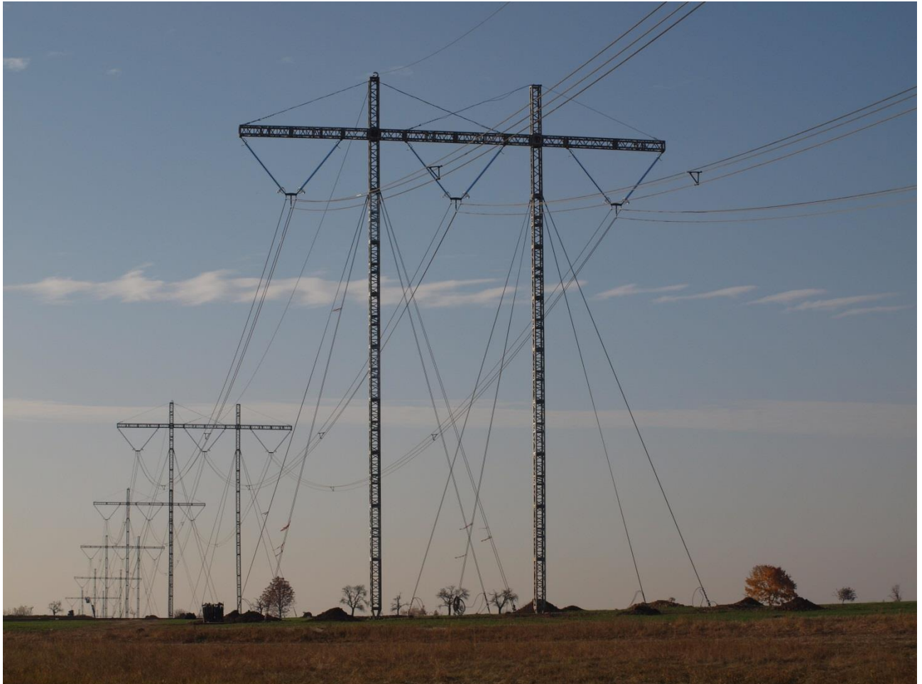
Abbildung 15: Beispiel für ein 380-kV-Freileitungsprovisorium (Quelle: SAG)
