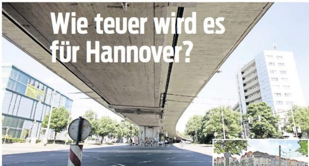
MARODE: Die Schnellwegbrücke über die Hildeshelmer Straße. Stadt und Land wollen deshalb einen Tunnel bauen. Foto: Dehrens
