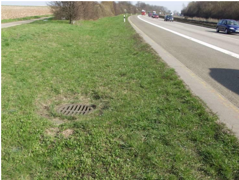
Abbildung 3-3: Muldenentwässerung an der A6 zwischen Sinsheim und Heidelberg (Foto Lambert)
