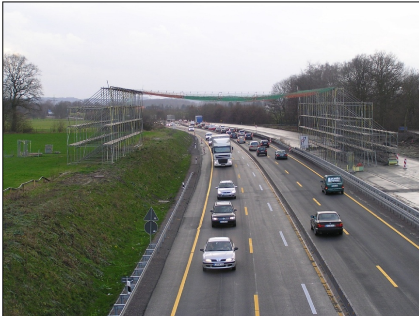
Abbildung 10: Stahlrohrschutzkonstruktion mit Netz über einer Autobahn
