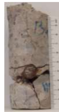
Bohrkern aus der Bodenplatte mit Trennrissen im Beton
